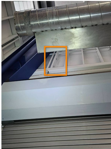
Back left corner above garage door
